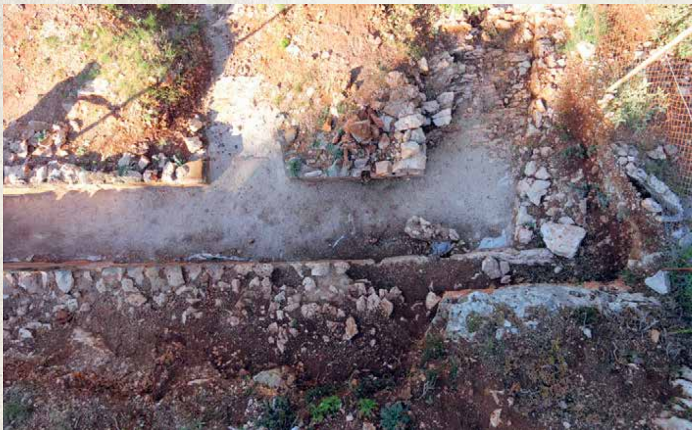
Διαμόρφωση για την απορροή πλεονάζοντος ύδατος / Structure which facilitates occasional overflow or draining
