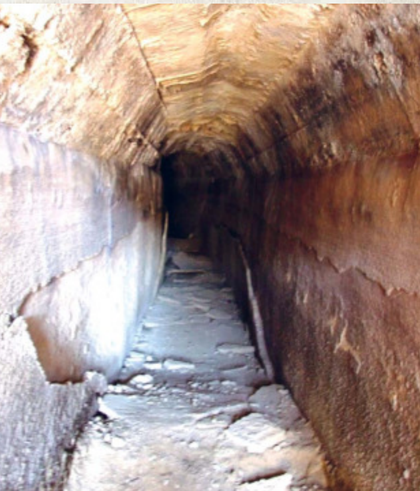
Άποψη από το εσωτερικό του αγωγού του υδραγωγείου στην περιοχή της Παλαιομάνας The conduit's interior in the area of Palaiomana
