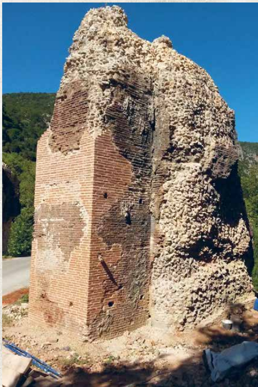
Πεσσός στην περιοχή του Αγίου Γεωργίου μετά τις εργασίες αποκατάστασης / Pier in the area of Aghios Georgios after conservation and restoration works
